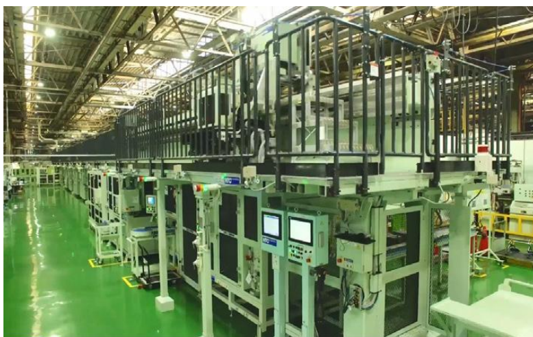
写真-6 プロジェクト B-① 工場内建屋及び設備の省エネ化導入例 (コマツ小山工場 スマートライン)
