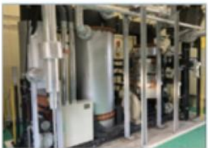
茨城工場のバイオマスボイラー
