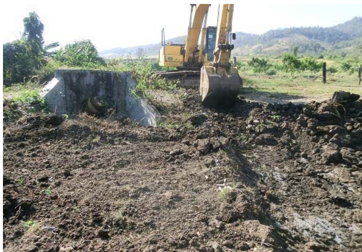
吐出したヒューム管
