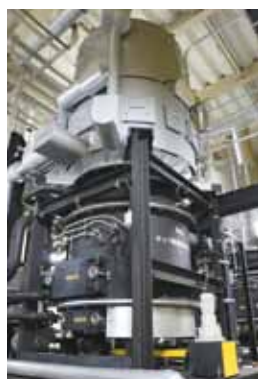
バイオマス蒸気ボイラ Biomass steam boiler
